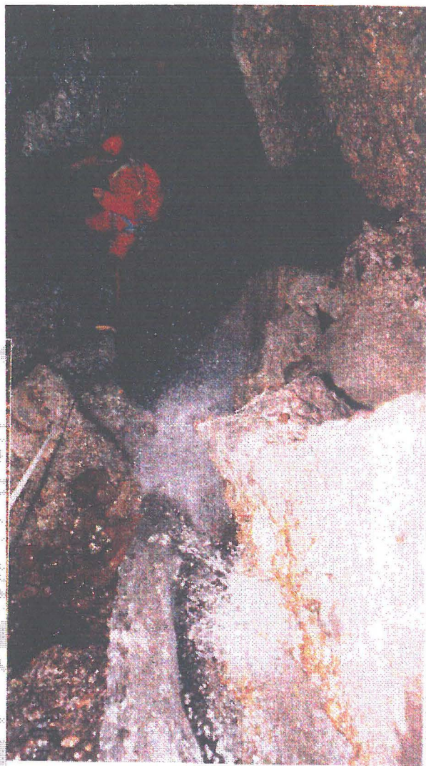
Entrée du POI avec un niveau d'eau bas
